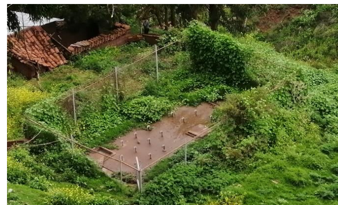
Imagen N° 15: Pozo séptico que recibe aguas residuales, presenta rebose de agua residual que discurre hacia la quebrada "Checcollochayoc".
