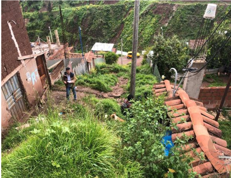
Imagen N° 18: Calle peatonal en la APV Virgen Concepción, carece de drenaje pluvial.
